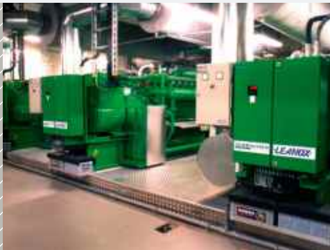
Sprężyste posadowienie agregatów kogeneracyjnych
