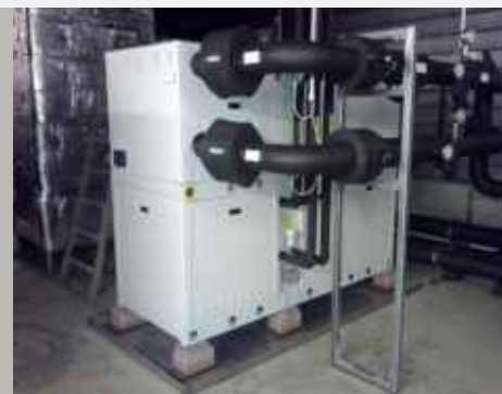
Posadowienie agregatu chłodniczego na izolatorach Isotop® SE-DE
