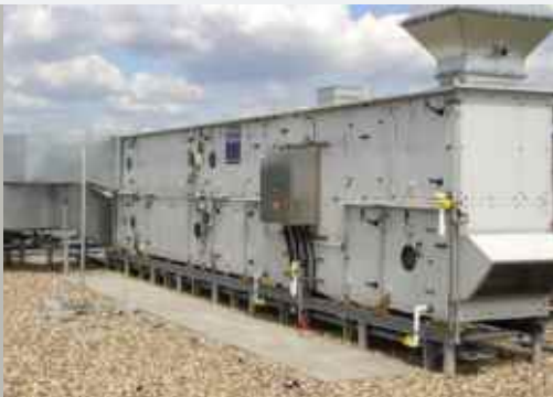
Sprężyste posadowienie urządzeń wentylacyjno-klimatyzacyjnych
